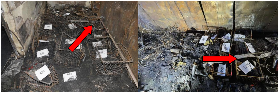
0625 号吊篮附近烧损情况
