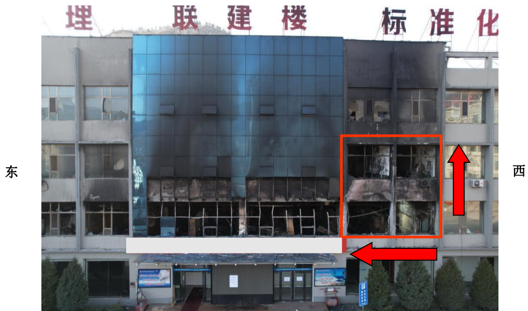
联建楼烧损情况
